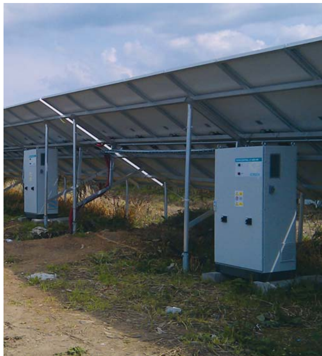
Obr. K optimalizácii FVE výrazne prispieva aj umiestnenie invertorov, napr. umiestnenie pod panely vytvára ich ochranu pred prehrievaním priamym slnkom alebo pred snehom.
