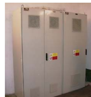
Obr.3 Riešenie regulácie ventilátorov s FM VQFREM 400 V – 132 kW a VQFREM 400 V – 75 kW v rozvádzačovom vyhotovení
