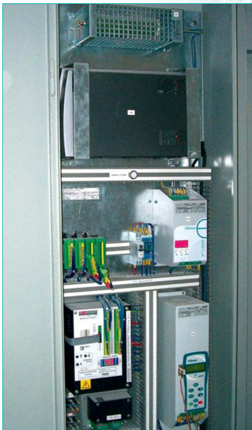
Hore: záložný zdroj UPS, Stred: VQFREM 230 E – regulácia otvárania dverí, Dole: VQFREM 400 – regulácia posuvu kabíny
