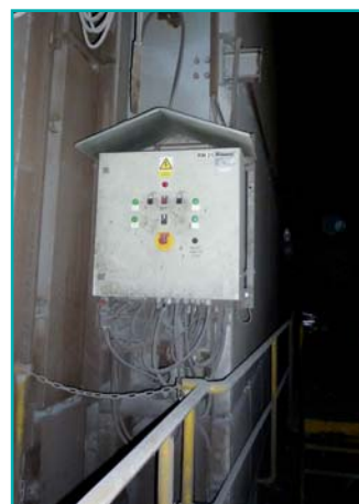
Kompletný rozvádzač s meničmi a výbavou
