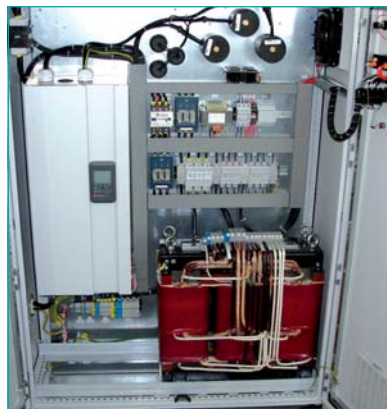
Umelá sieť 30 kVA s elektrovýbrojou a signalizáciou
