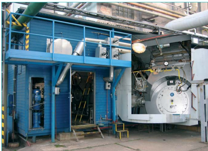
Energetická optimalizácia plynového kotla pomocou FM + RS VONSCH
